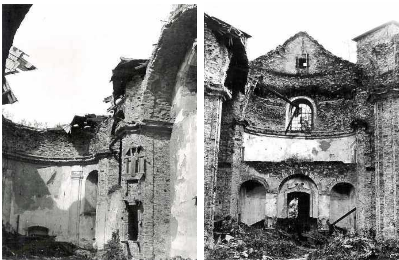
Vues prises de l'entrée principale et du maître-autel après l'écroulement des toit à la fin des années 60, état en 1972.
