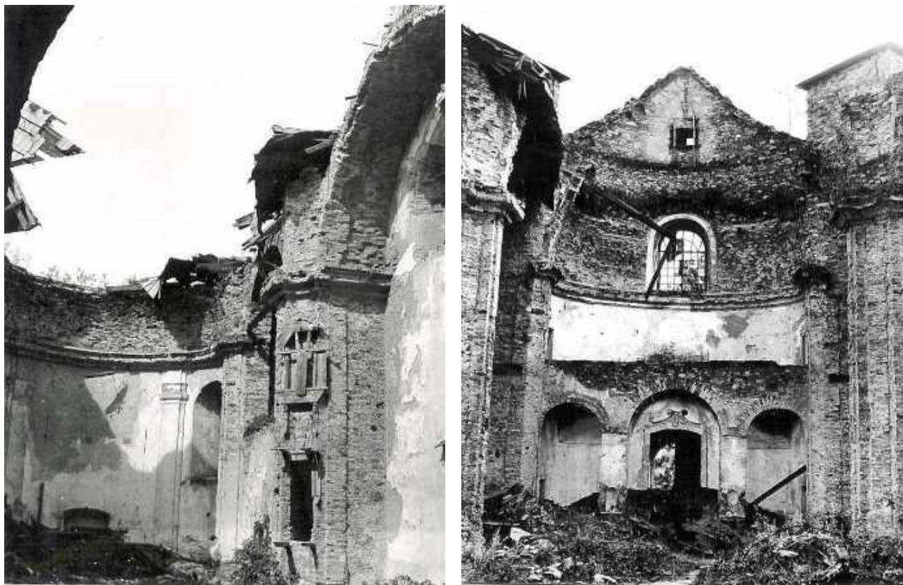
Pohled k oltáři a hlavnímu vchodu po zřícení střechy na konci šedesátých let, stav z roku 1972.
